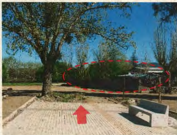
Fotografía N° 5 - 22/09/16: Vista de paseo peatonal en ejecución discontinua en calle 7 Sur, entre 1 y 2 Oriente, en dirección Oriente-Poniente, producto de la falta de entrega de terreno de la propiedad que se encuentra demarcada.
