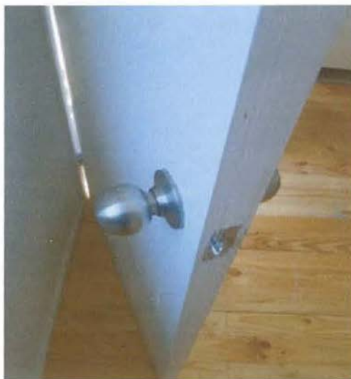
Foto N° 70 Cerradura instalada en puerta acceso principal no corresponde
