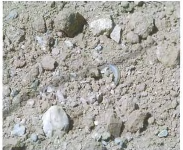
Foto N° 34 Material de relleno contiene basura y vidrios, calle [REDACTED]
