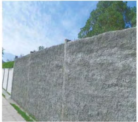
Foto N° 99 Cierre perimetral distinto al especificado
