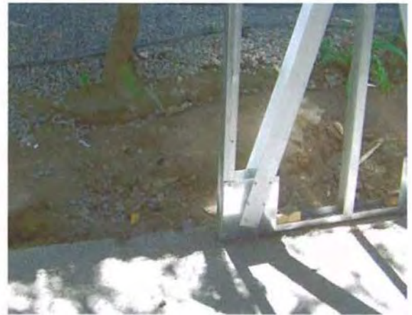
Foto N° 52 Diagonales no fueron dispuestas correctamente
