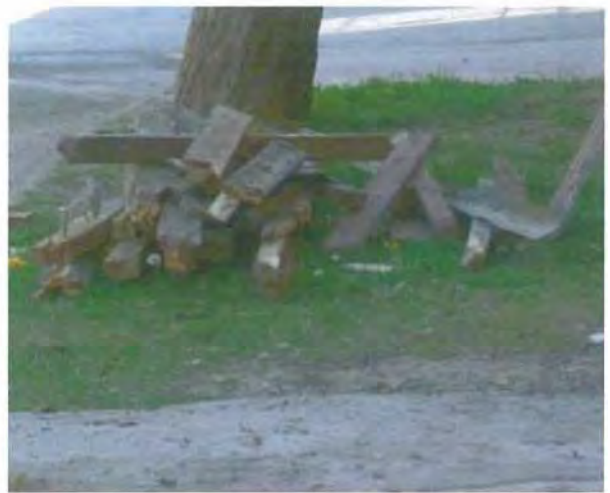
Foto N° 101 Falta retiro de escombros
