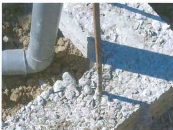
Foto N° 61 Sobrecimiento irregular y con nidos de piedra
