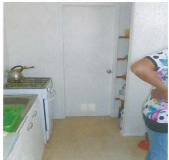
Foto N° 71 Cerradura instalada en la cocina no corresponde
