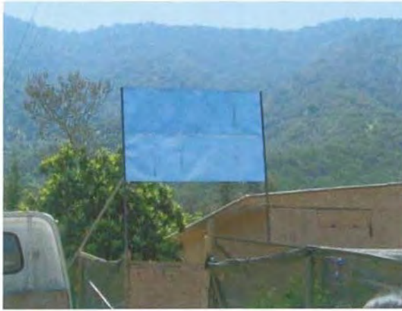
Foto N° 67 Letrero de obra sin instalar
