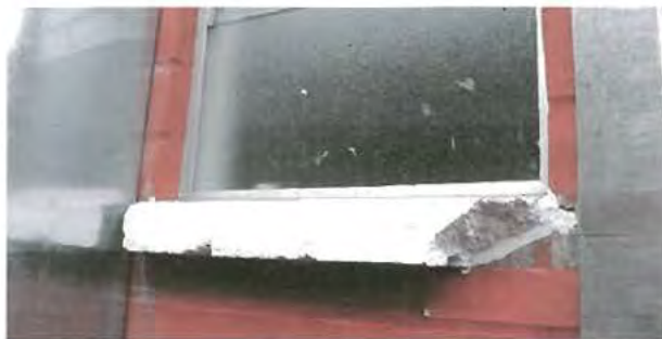
Fotografía N° 50: Vista de los elementos de alfeizar defectuosos instalados en las viviendas.
