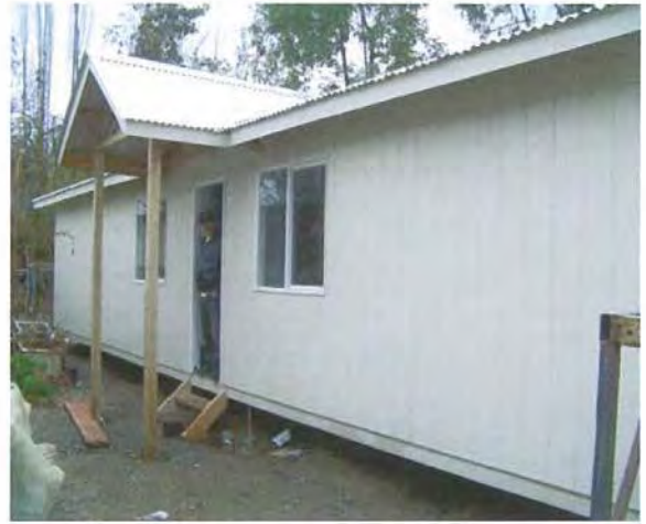
Foto N° 73 Falta de pastelones en entrada principal
