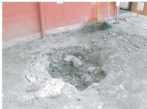
Fotografía N° 55: Vista de asentamiento del terreno natural por filtración en cámaras del sistema.
