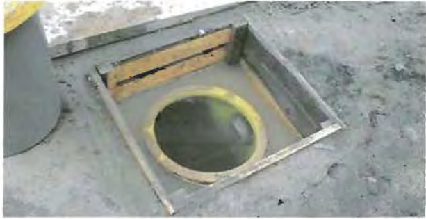
Fotografía N° 51: Vista del estado de la fosa séptica inundada.
