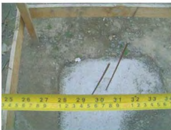
Foto N° 45 Distanciamientos inferior a 1,40m, hacia el límite predial. Vivienda ubicada en calle [REDACTED]
