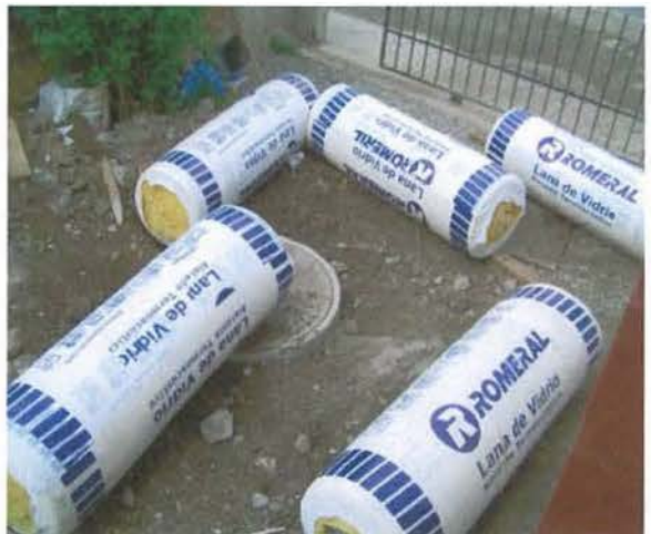
Foto N° 42 Materiales a la intemperie, calle [REDACTED]
