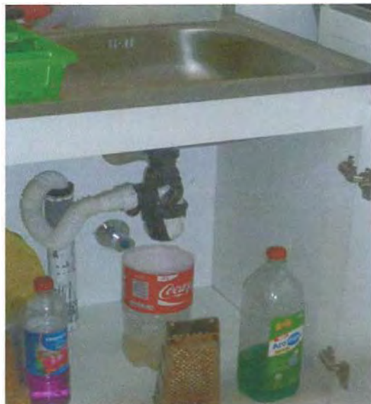
Foto N° 76 Deficiente instalación del sifón desengrasador del lavaplatos, con filtración de agua
