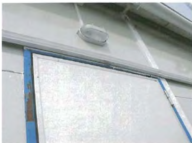
Fotografía N° 68: Detalle del estado de los marcos metálicos de las puertas.
