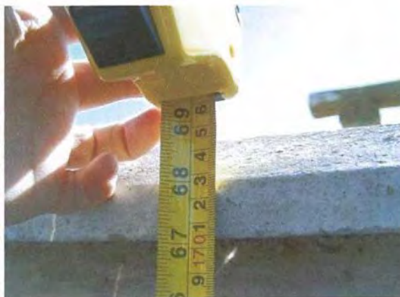
Foto N° 82 Altura inferior a la especificada, calle [redacted]
