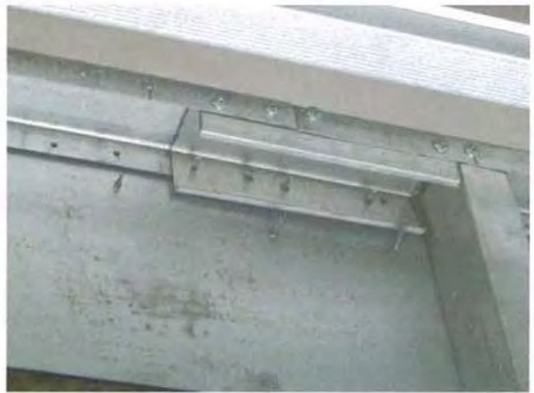
Foto N° 54 Revestimientos no afianzados debidamente a la estructura
