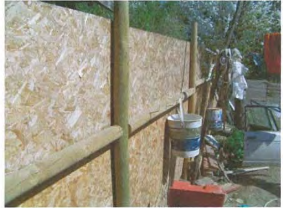
Foto N° 79 Trabajos sin ejecutar. Reparación provisoria por el propietario
