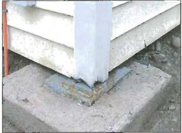
Fotografía N° 34: Detalle de uno de los esquineros de siding retorcido y manchada producto de la soldadura efectuada en la zona inferior contigua.
