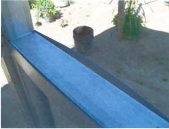
Foto N° 49 Incorrecta instalación de las pletinas de arriostamiento
