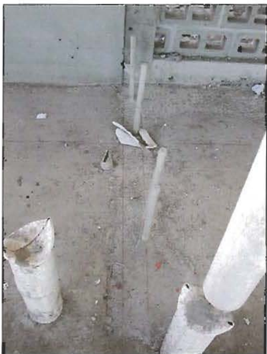
Fotografía N° 3: Detalle del desfase existente entre el trazado de los tabiques interiores y los tubos de la red de agua potable.
