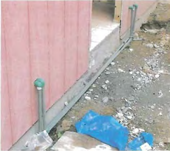
Fotografía N° 72: Detalle de las instalaciones exteriores de agua potable de las casas tipo Molco.
