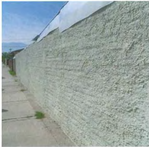
Foto N° 98 Cierre perimetral distinto al especificado
