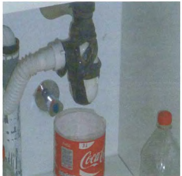
Foto N° 77 Deficiente instalación del sifón desengrasador del lavaplatos, con filtración de agua
