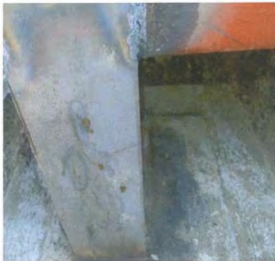
Foto N° 74 Vigas maestras sin la protección especificada
