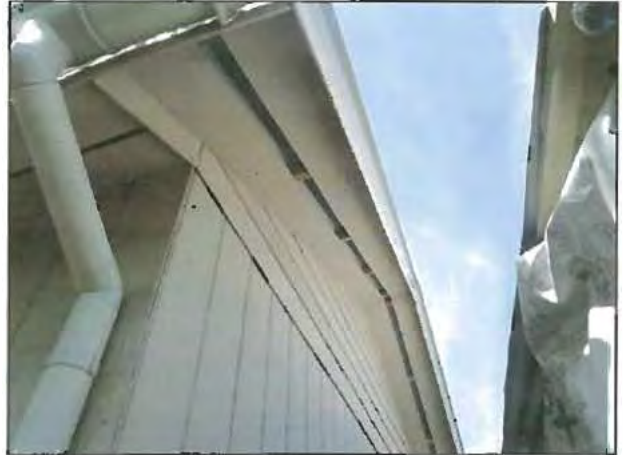
Fotografía N° 36: Detalle de otra separación de la zona central del alero con una abertura de 2,7 cm.
