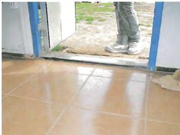
Fotografía N° 67: Vista del desnivel existente en el acceso las viviendas.
