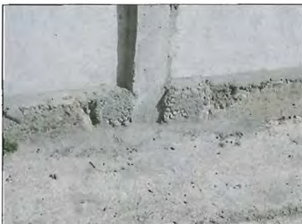
Fotografía N° 79: Detalle de la fundación desalineada del pilar del cierre tipo pandereta visto desde la calle (casa esquina).
