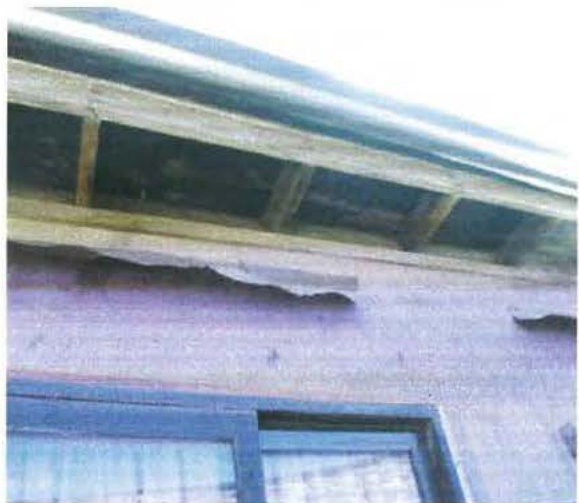
Foto N° 105 Trabajos realizados no concuerdan con los presupuestados, vivienda de [REDACTED]
