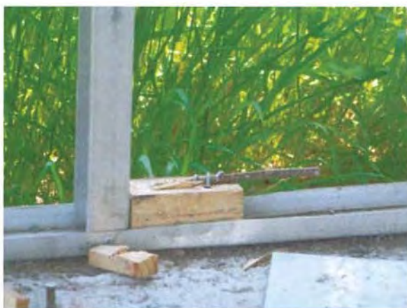
Foto N° 48 Fijación irregular de la tabiquería al sobrecimiento
