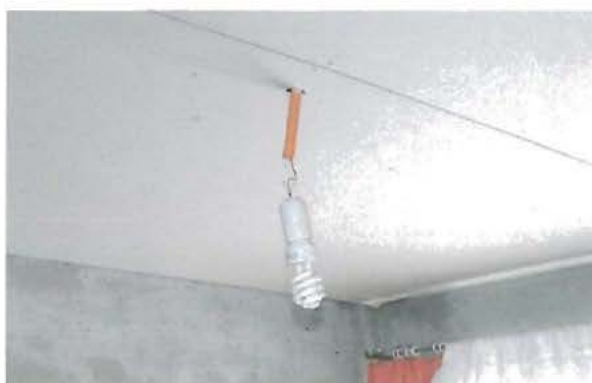
Fotografía N° 59: Detalle de los portalámparas instalados en las viviendas.
