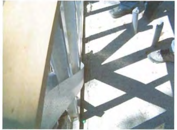
Foto N° 50 Diagonales sin tensar
