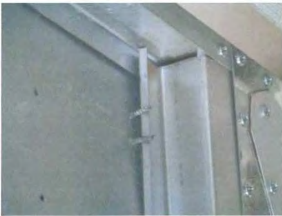
Foto N° 53 Excesivas perforaciones en perfiles
