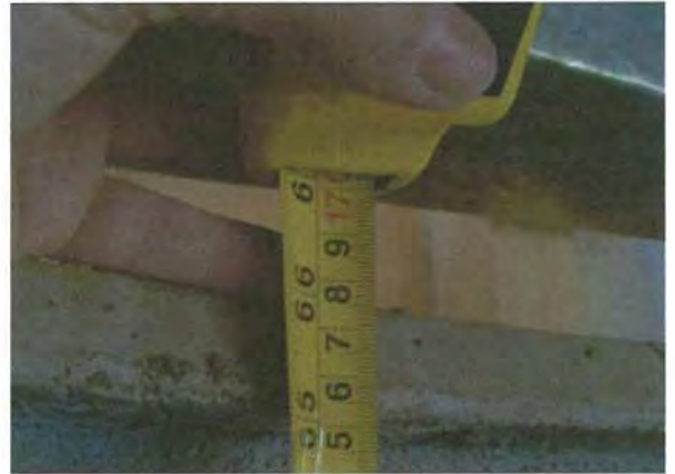
Foto N° 81 Altura inferior a la especificada, calle [redacted]
