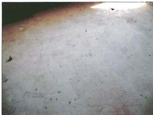
Fotografía N° 5: Vista de la superficie fisurada de uno de los dormitorios de una vivienda, desprovista de juntas de retracción. The image shows a wide view of a concrete floor in a bedroom, characterized by numerous small, dark spots and a network of fine cracks across its surface.
