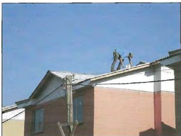
Fotografía N° 14: Vista de un trabajador en faena en altura, desprovisto de arnés de seguridad y/o cuerda de vida.
