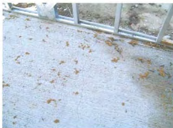
Foto N° 62 Radier se encuentra fisurado en varios puntos
