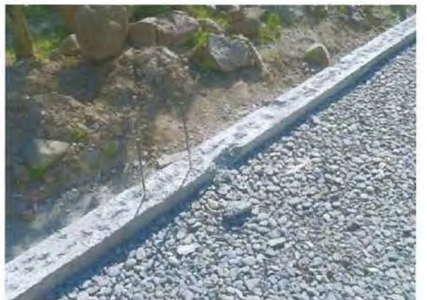
Foto N° 60 Sobrecimiento con bordes quebrados [REDACTED]
