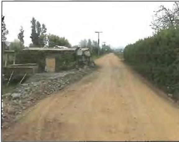
Fotografía N° 33: Vista de los trabajos realizados en la vía pública sin prevenir con señalética de advertencia.
