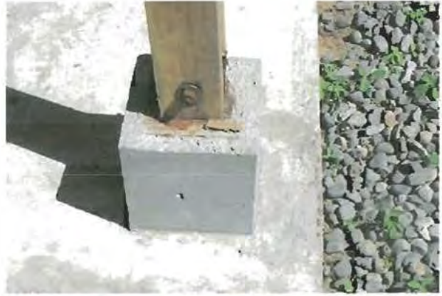
Fotografía N° 57: Detalle de los elementos metálicos expuestos a la intemperie sin protección.
