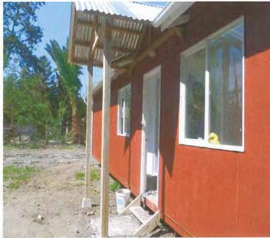
Foto N° 72 Falta la faja de pastelones en entrada principal
