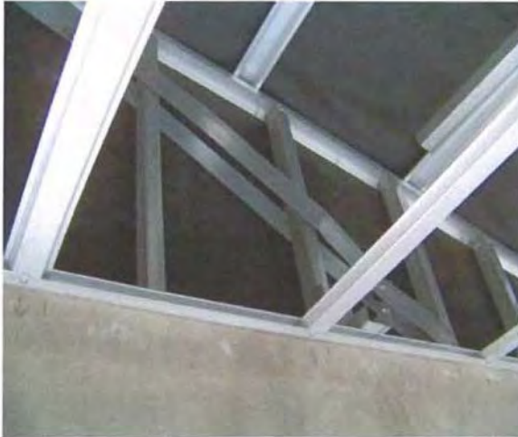
Foto N° 37 La diagonal del frontón no está debidamente tensada, calle [REDACTED]
