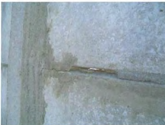
Foto N° 94 Emboquillado desprendido, calle [REDACTED]
