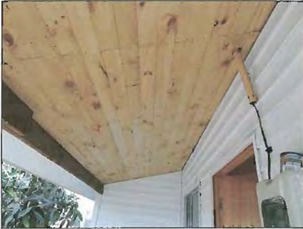
Fotografía N° 100: Ilustración del alero de madera desprovisto de pintura barniz.
