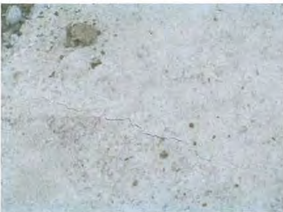
Foto N° 59 Fisuras en fundaciones, calle [REDACTED]
