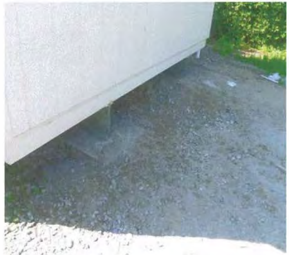
Foto N° 75 Vigas maestras sin la protección especificada
