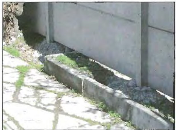
Fotografía N° 78: Vista de la fundación esparcida de dos pilares del muro tipo bulldog. Cabe señalar, que la imagen fue registrada desde el patio del beneficiario.
