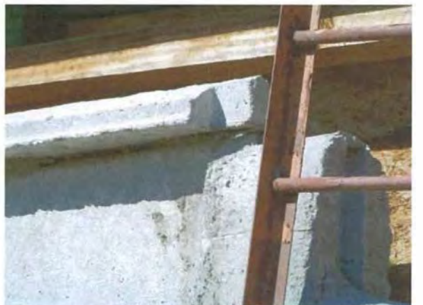
Foto N° 95 Barda sin confinar y afianzar, calle [REDACTED]
