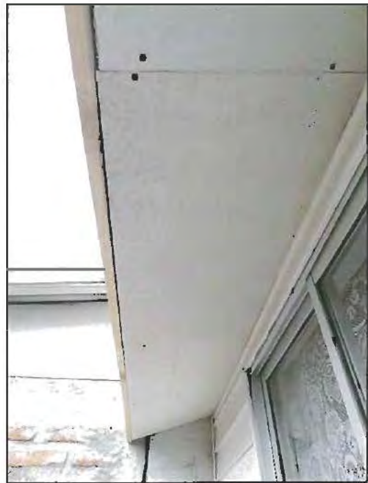
Fotografía N° 101: Detalle del alero lateral sin contar con la aplicación de la pintura látex instruida en las especificaciones técnicas del proyecto.
