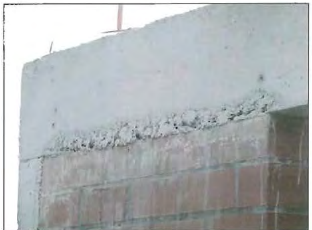
Fotografía N° 20: Vista ilustrativa de los nidos de piedra existente en una cadena, situación que ha generado además que la enfierradura interior no posea un recubrimiento igual o superior a 2 cms.
