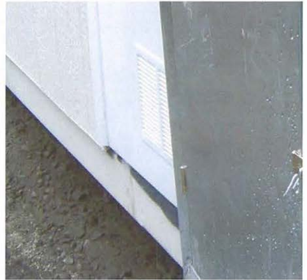
Foto N° 69 Falta de botaguas en puertas a la interperie
