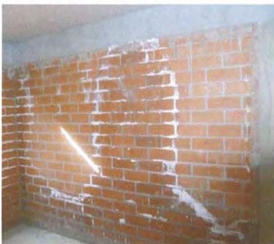
Foto N° 15 Falta de aplicación de impermeabilizante
