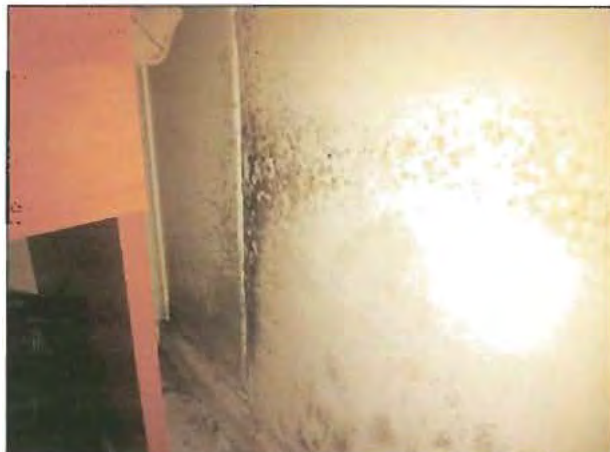
Fotografía N° 30: Detalle de la aparición de hongos a en el interior de un dormitorio de la vivienda.
