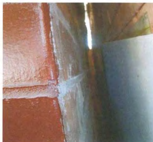
Foto N° 16 Detalle falta de aplicación de impermeabilizante
