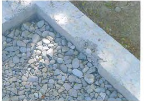
Foto N° 58 Sobrecimiento quebrado, calle [REDACTED]
