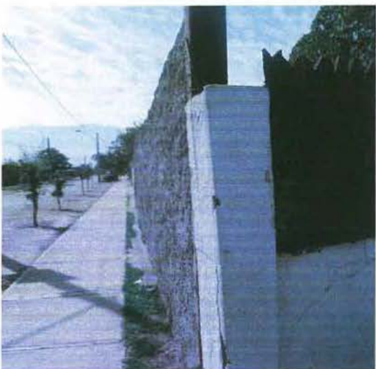
Foto N° 106 Cierre perimetral desplomado
