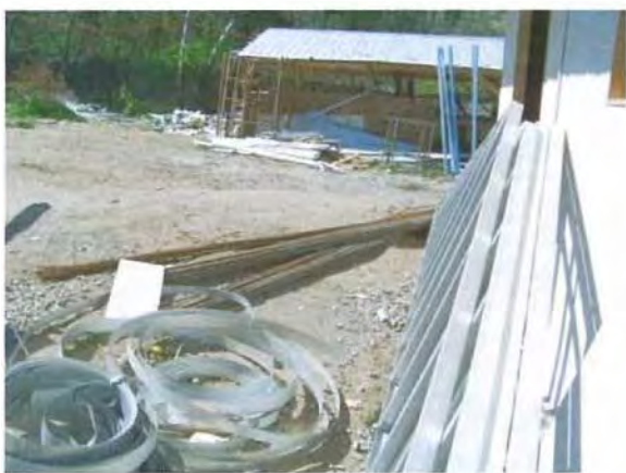
Foto N° 65 Materiales acopiados en la interperie
