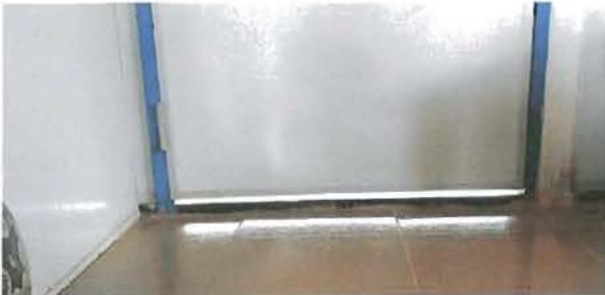
Fotografía N° 65: Vista de los defectos recurrentes de aberturas y separación existentes en las puertas de las viviendas.
