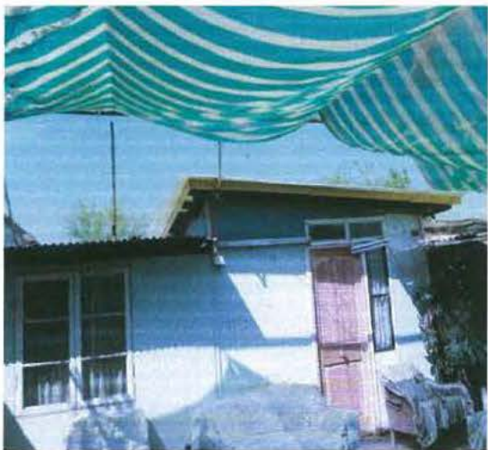
Foto N° 104 Trabajos realizados no concuerdan con los presupuestados, vivienda de [REDACTED]
