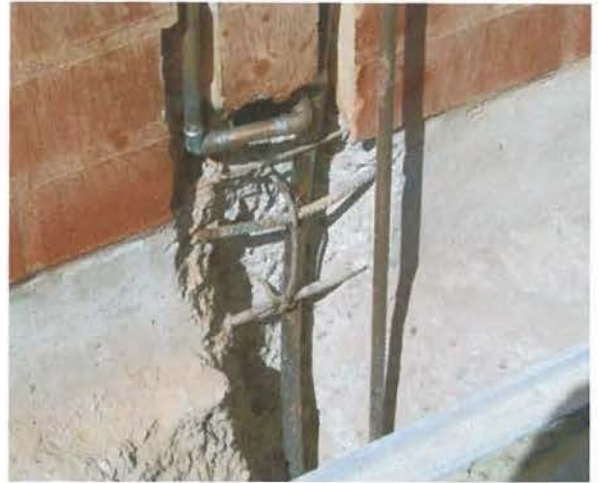
Foto N° 38 Sobrecimiento intervenido y cañerías de cobre sin aislamiento en puntos de contacto con fierros, calle [REDACTED]
