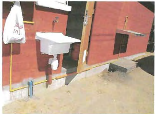
Fotografía N°49: Vista de los artefactos de lavaderos instalados al exterior de las viviendas sin el atril respaldo.
