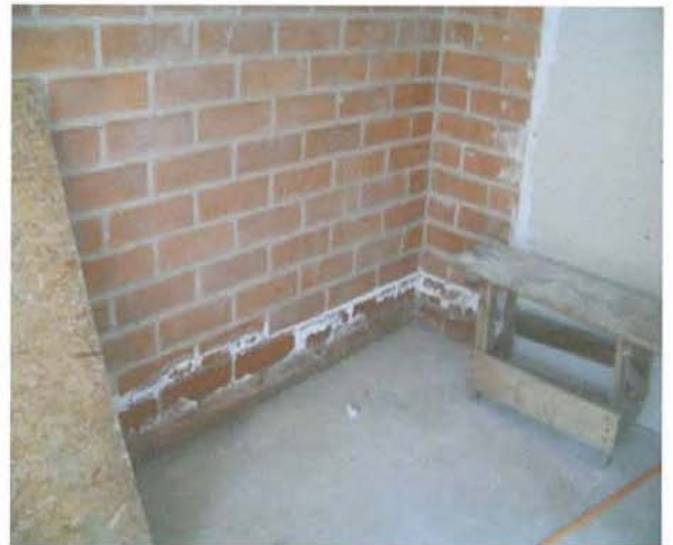
Foto N° 26 Presencia de humedad en muros
