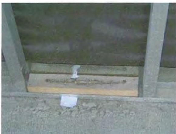
Foto N° 47 Fijación irregular de la tabiquería al sobrecimiento
