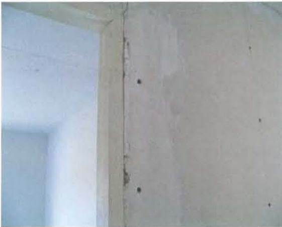
Foto N° 39 Tabique de acceso al baño presenta planchas quebradas, calle [REDACTED]
