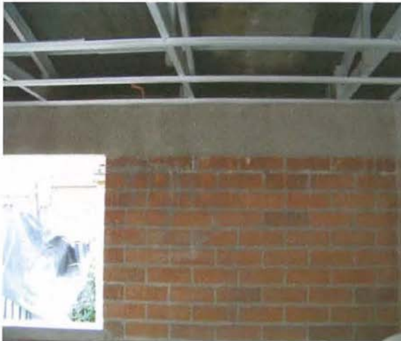
Foto N° 25 Presencia de humedad en muros
