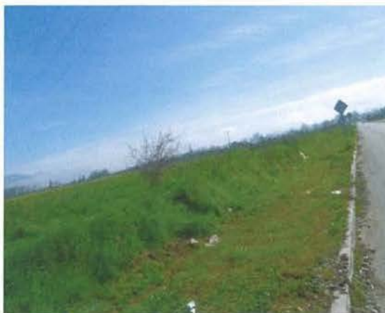
Foto N° 5 Visita a terreno 01/09/11, obras sin iniciar, no concuerda con avance del 10% informado
