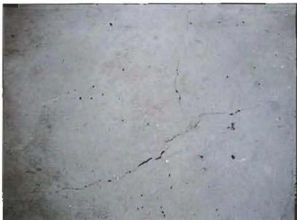
Fotografía N° 4: Detalle de las fisuras detectadas.
