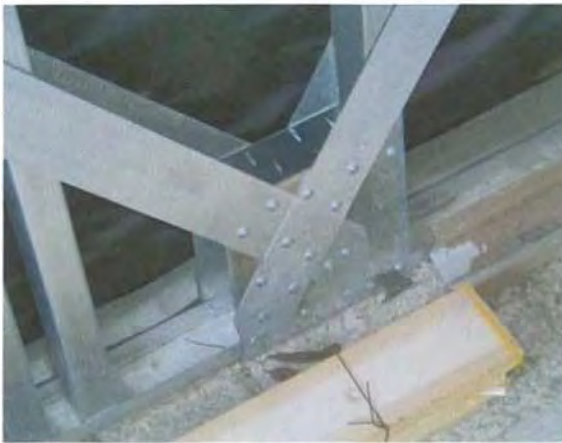
Foto N° 51 Diagonales no fueron dispuestas correctamente.
