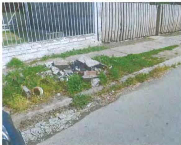
Foto N° 88 No se retiraron los escombros, calle [redacted]
