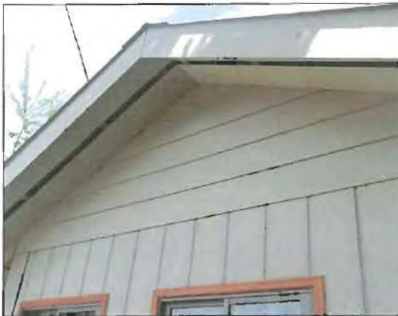
Fotografía N° 35: Vista de la separación central del alero la cual asciende a 3 cm.
