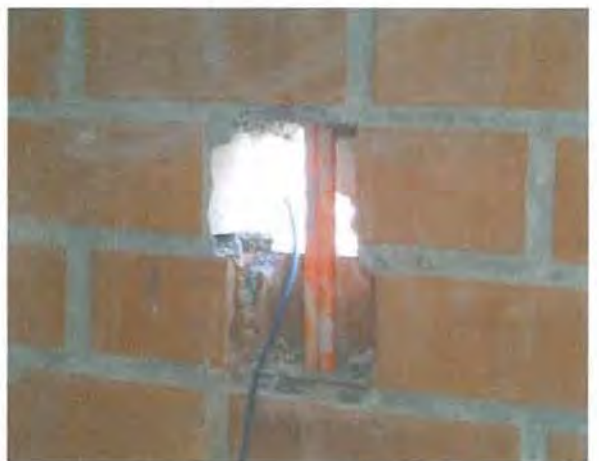
Foto N° 36 Perforación excesiva en muro, vivienda ubicada en calle [REDACTED]
