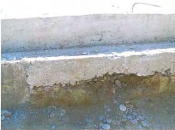
Foto N° 57 Nidos de piedra y socavación, calle [REDACTED]
