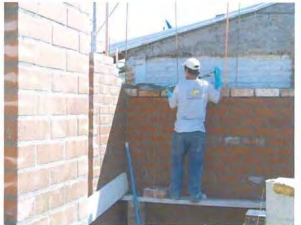
Foto N° 28 Personal sin implementos de seguridad
