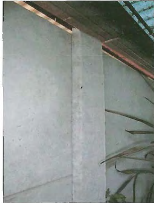
Fotografía N° 76: Detalle del encuentro del pilar con la placa pandereta desprovista del remate con mortero que asegura la inmovilidad de dichos elementos.
