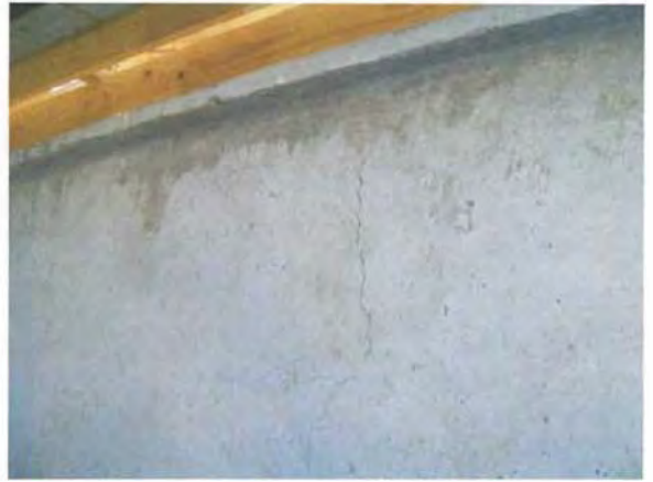
Foto N° 97 Placas fisuradas, calle [redacted]
