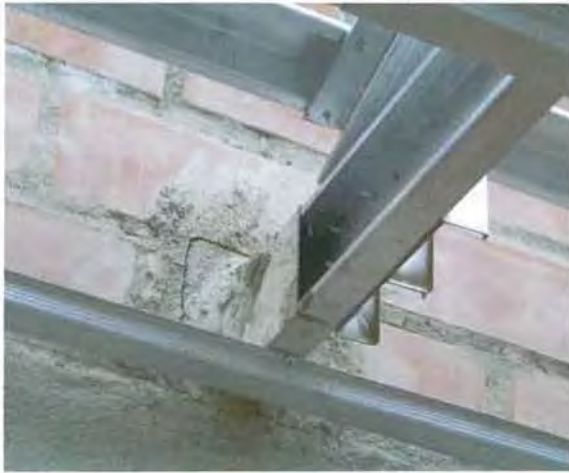
Foto N° 31 Mortero de relleno presenta fisuras y aplicación irregular, en calle [REDACTED]
