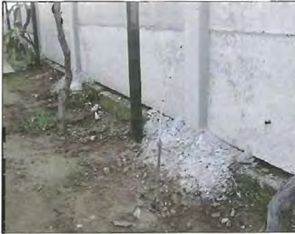
Fotografía N° 75: Elevación de las fundaciones esparcidas sucesivas de un cierre tipo bulldog. Cabe señalar, que la imagen fue registrada desde el patio de un vecino del beneficiario.
