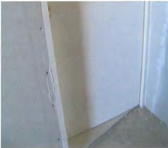
Foto N° 33 La puerta de baño no cuenta con rejilla de ventilación, calle República de [REDACTED]
