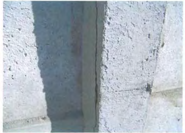
Foto N° 91 Emboquillado desprendido, calle [REDACTED]
