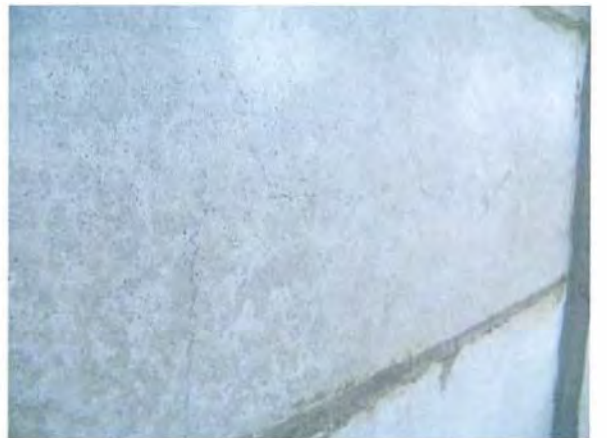
Foto N° 93 Presencia de humedad, placas fisuras y con oscilación, calle [REDACTED]
