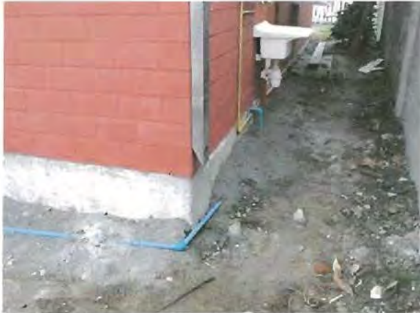
Fotografía N° 48: Vista de las tuberías exteriores a la vista de la instalación de agua potable de las viviendas.
