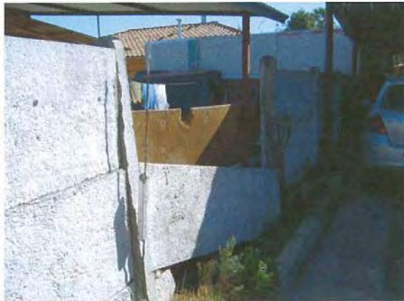
Foto N° 80 Trabajos sin ejecutar. Riesgo de caída
