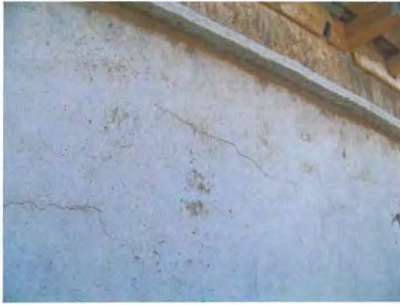
Foto N° 96 Placas fisuradas, calle [redacted]
