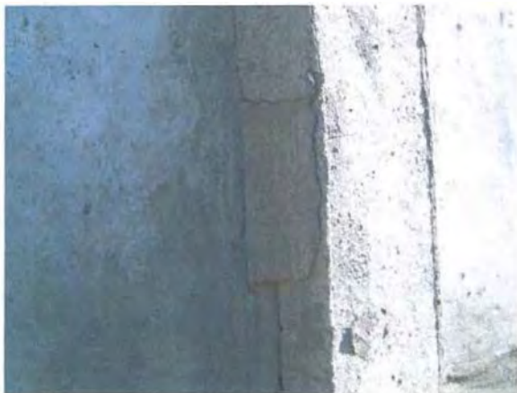
Foto N° 92 Emboquillado desprendido, calle [REDACTED]
