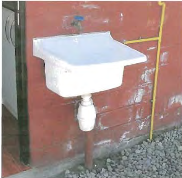
Fotografía N° 60: Vista de los lavaderos instalados en las viviendas.
