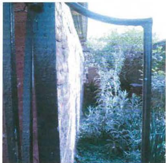
Foto N° 107 Cierre perimetral desplomado
