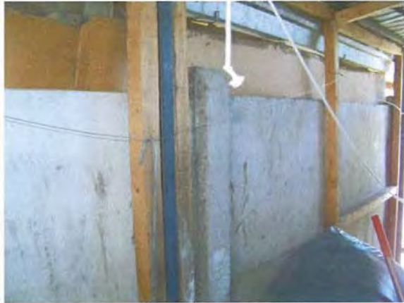
Foto N° 78 Trabajos sin ejecutar
