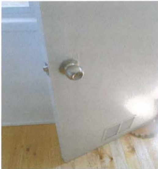
Foto N° 68 Falta de botaguas en puertas a la interperie
